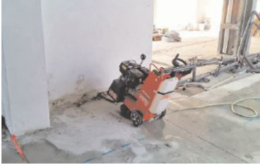
Eines der Baugeräte dürfte defekt gewesen sein und so zu einem CO-Anstieg geführt haben. Foto: FF St. Pölten-Stadt
