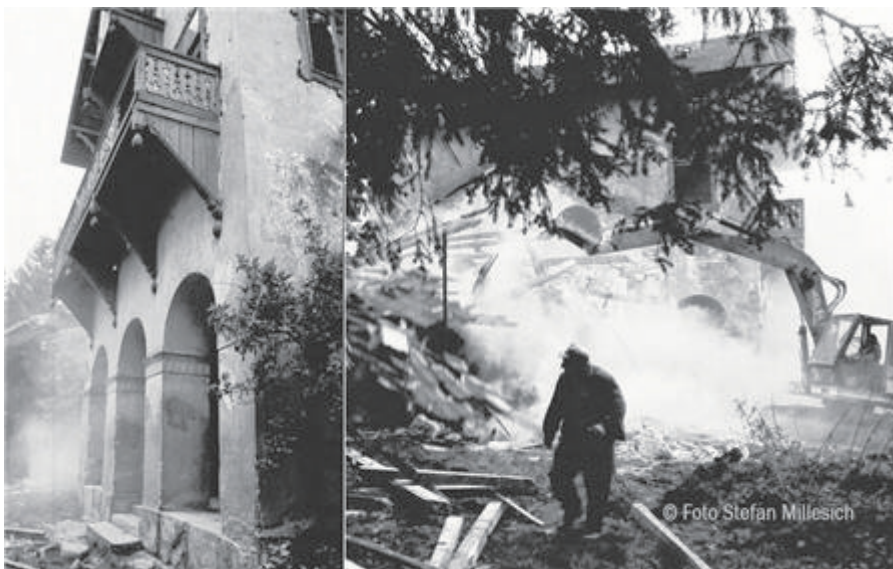
Schließlich wurde das Gebäude baufällig und in den 1980er Jahren im Auftrag der Esterházy-Betriebe geschliffen, weil es eine Gefahr für Wanderer sei. Fotos: Stefan Millesich
