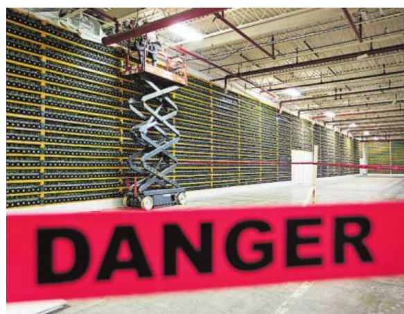
Reparaturen in einer Bitcoinfarm in Quebec. Bitcoins verbrauchen viel Strom. [AFP]
